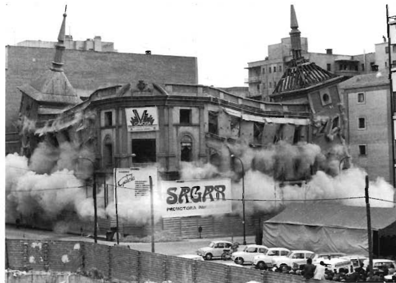
Voladura del edificio del diario «Madrid». 24 de abril de 1973.
